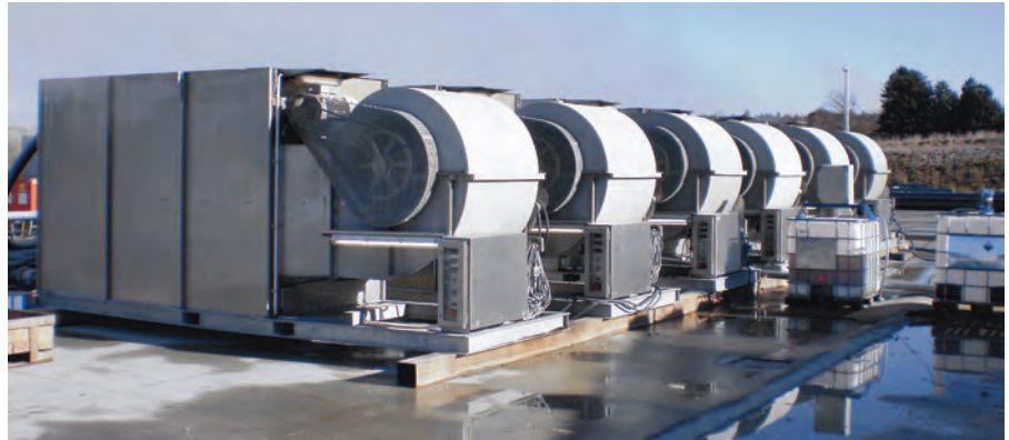
Kühlleistung ca. 21 MW, Temperaturdifferenz 80 °C bis 35 °C
